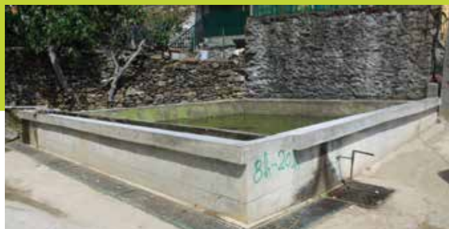
TANQUES DE ÁGUA
