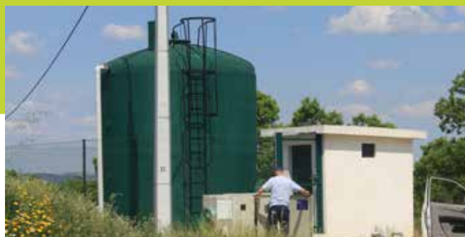
FRADES - RESERVATÓRIO DE ÁGUA EM FUNCIONAMENTO
