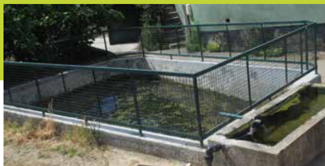
TANQUES DE ÁGUA
