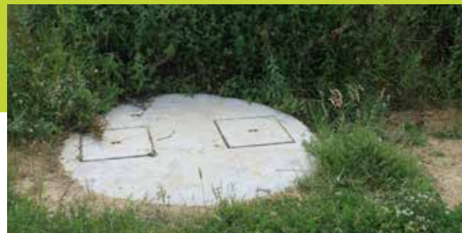
ESTAÇÃO ELEVATÓRIA DE ÁGUA DE NASCENTE PARA RESERVATÓRIO
