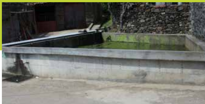
TANQUES DE ÁGUA
