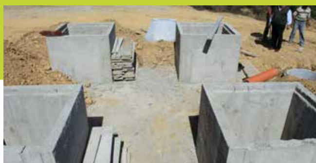
SANTALHA - FOSSA SÉPTICA DOS SANEAMENTOS
